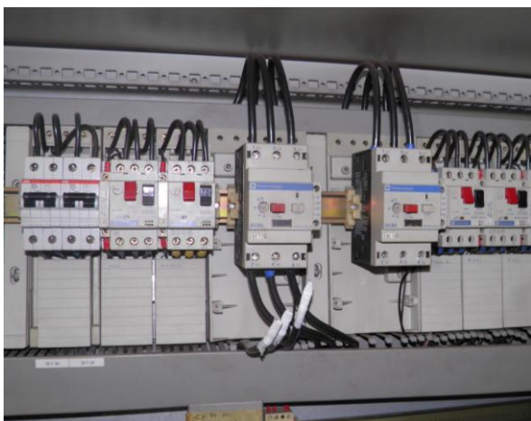
Εικόνα 28: Η συνδεσμολογία η οποία πραγματοποιήσε ο Προϊστάμενος ηλεκτρολόγος για τροφοδοσία της Νο. 1 αντλίας κυκλοφορίας θερμαντικού ελαίου από τον διακόπτη της Νο. 2 αντλίας
