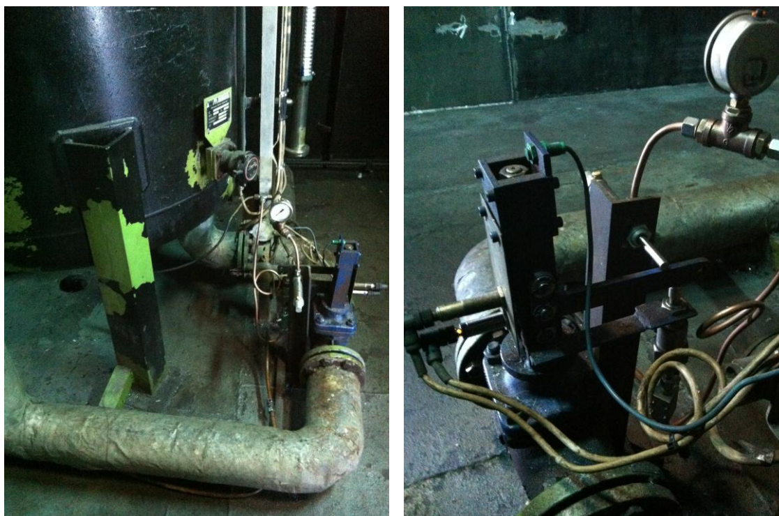
Εικόνα 25: Η δεξαμενή διαστολής και το επιστόμιο εκκένωσης με τον μηχανισμό τηλεχειρισμού.
