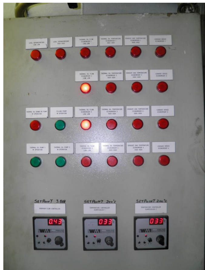
Εικόνα 26: Αριστερά η οθόνη εποπτείας της λειτουργίας της εγκατάστασης καυστήρων στο ECR και δεξιά το άνω μέρος του πίνακα ελέγχου της εγκατάστασης βοηθητικού λέβητα και οικονομητήρων.
