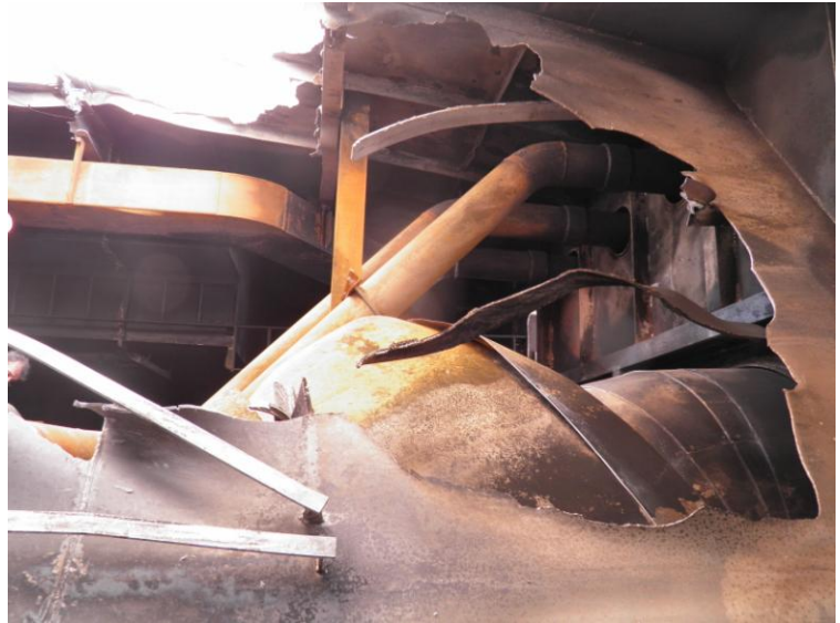
Εικόνα 8: Τήξη αλουμινένιου δαπέδου άνω εσωτερικού τμήματος της καπνοδόχου.
