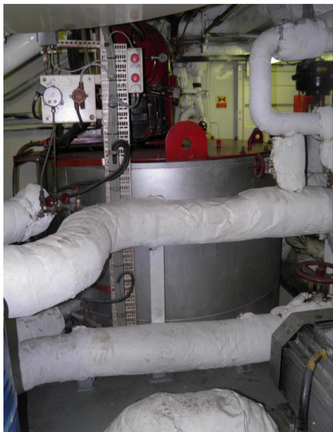
Εικόνα 20: Το άνω μέρος του βοηθητικού λέβητα στο Κατάστρωμα Νο. 2 του λεβητοστασίου του ΝΗΣΟΣ ΜΥΚΟΝΟΣ.
