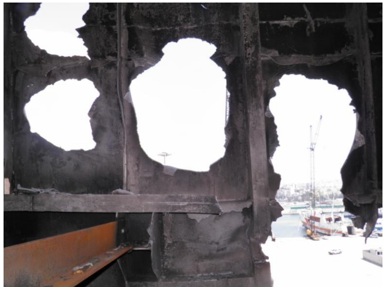
Εικόνα 9: Τήξη αλουμινένιου εξωτερικού τοιχώματος άνω τμήματος καπνοδόχου.
