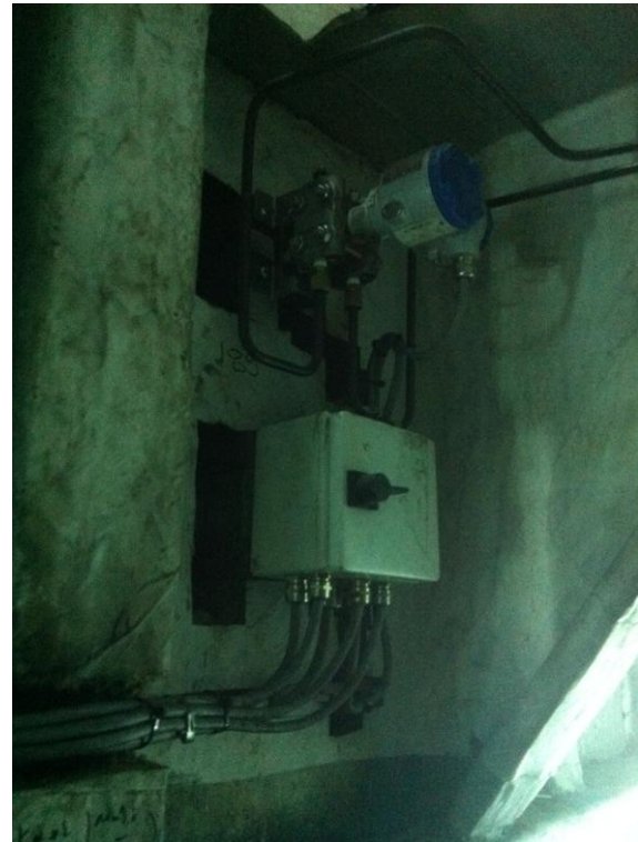
Εικόνα 34: Όργανο παρακολούθησης ροής θερμαντικού ελαίου, τοποθετημένο στον μπουλέ της καπνοδόχου.
